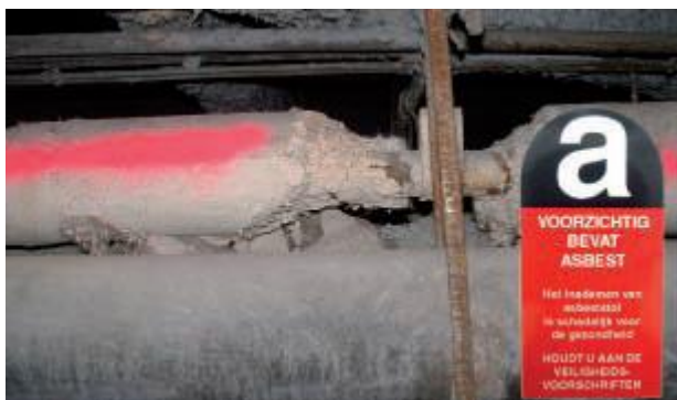
Figuur 1: Markering van een leiding met het asbestetiket
